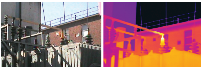
変電所の広角画像により、接続部の抵抗が高くなっている場所が即座に発見できる。電気機器の保守点検において、赤外線技術の効率性の高さは群を抜いている。
