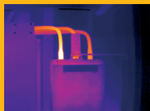
接続不良と内部損傷
