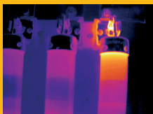
内部ヒューズの損傷
